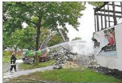
Nachlöscharbeiten: Um an die zahlreichen Glutnester heranzukommen, mussten mit einem Bagger Abrissarbeiten erfolgen.
