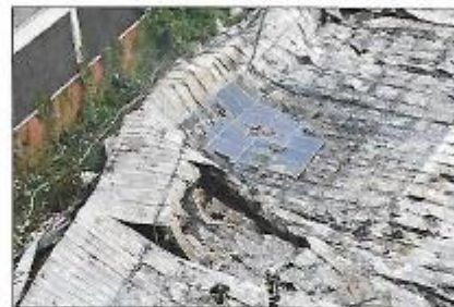
Solaranlage: Reste der zerstörten Solarstromanlage auf dem Dach der Tennishalle.
