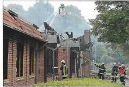
Einsturzgefahr: Die Nachlöscharbeiten konnten nur von außen und über die Drehleitern erfolgen.
